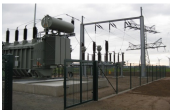
Den nyopførte transformestation i Görike
